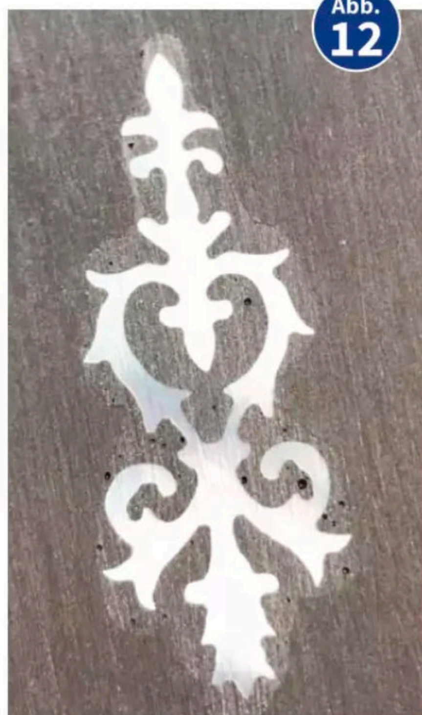
... im Detail ist die Oberfläche aber noch etwas unsauber.
