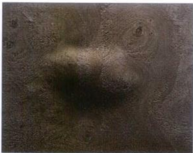
Burbuja causada por una aplicación irregular de la cola.
